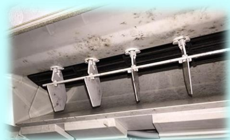
※汚れが溜まっているエアコンの一例
